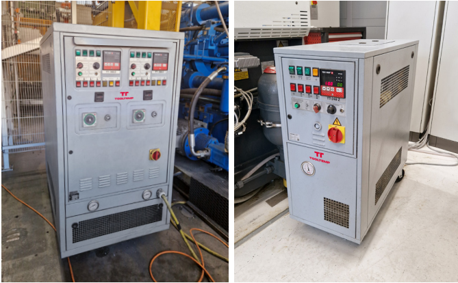
Unità di controllo della temperatura Tool-Temp in uso.
