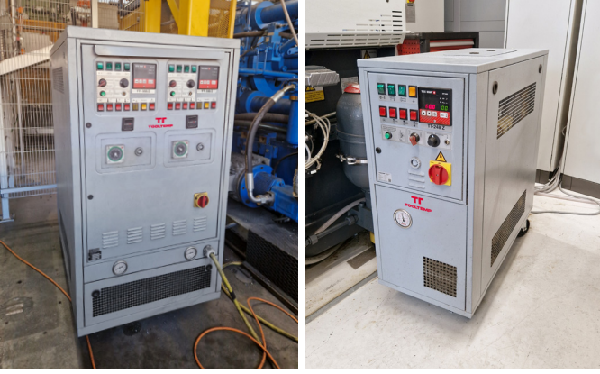
Saha uygulamasında TOOL-TEMP Sıcaklık Kontrol Üniteleri.
